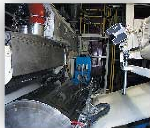
Extrusionsbeschichtung: ein Linescanner kontrolliert die Temperaturverteilung der Schmelze nach der Breitschlitzdüse
