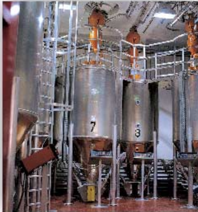
Die Tagessilos sind mit Graviko Wäge- und Dosiersystem einschließlich MCG-Steuerung ausgestattet
