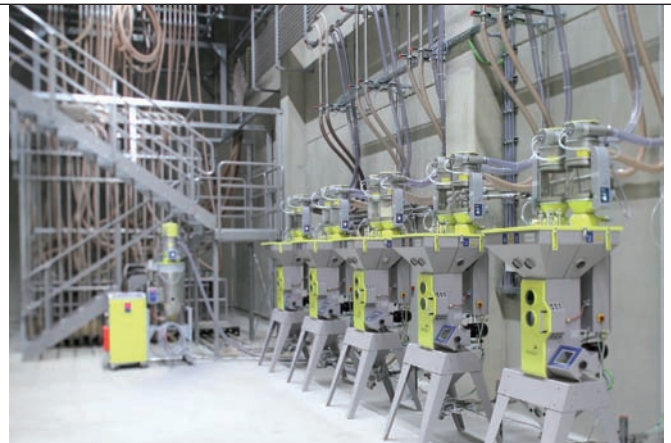
Vom Kupplungsbahnhof geht es in die Misch- und Dosiergeräte.
