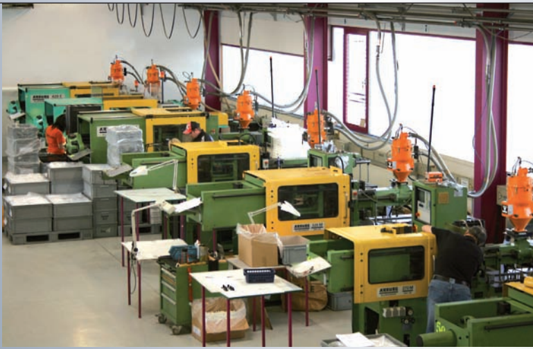
20 Spritzgießmaschinen werden mit der aus Zentralfördersystem, Trockenlufttrocknern, Trocknungsbehältern, Umsteckbahnhof und Misch- und Dosiergeräten bestehenden Anlage versorgt.
