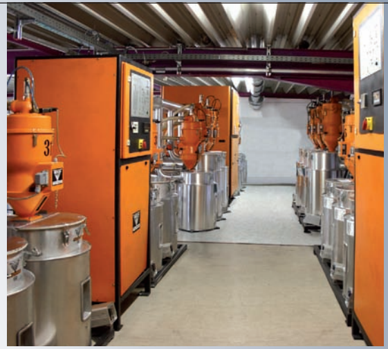
Die Trockenlufttrockner sind aus Platzspargründen auf einer speziell vom Anlagenlieferanten konstruierten Bühne positioniert.
