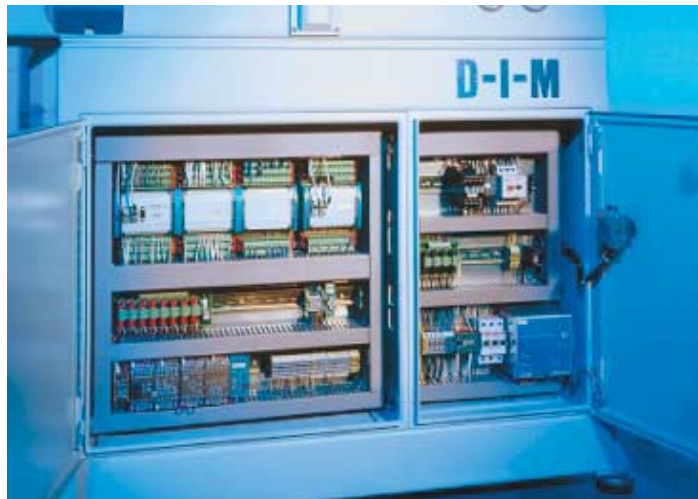
Sauber und aufgeräumt ist der Schaltschrank der Maschine (Bilder: Ettliger, Königsbrunn)
